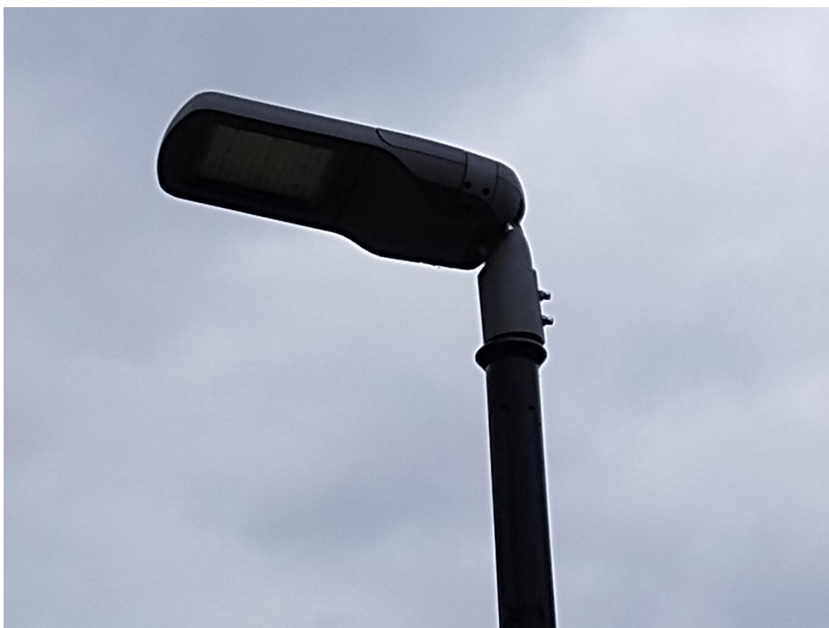
Foto 3,4: słup i oprawa oświetlenia ulicznego.
