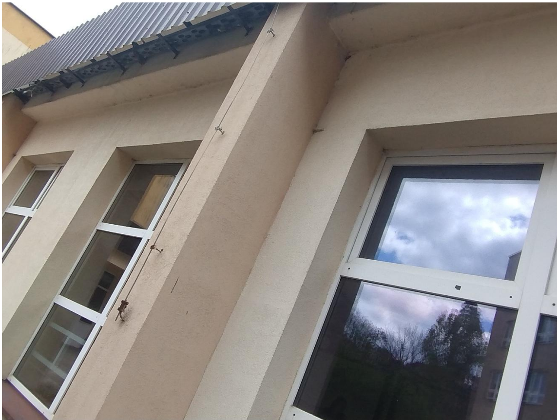
Foto 1, 2: koryto w szczytowej części budynku.
